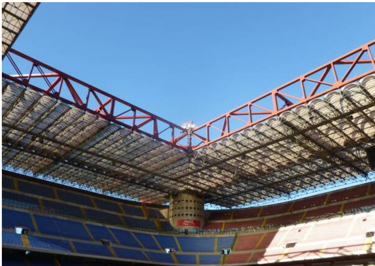
(2014 – Manutenzione del ciclo di verniciatura delle strutture della copertura dello Stadio di San Siro)
