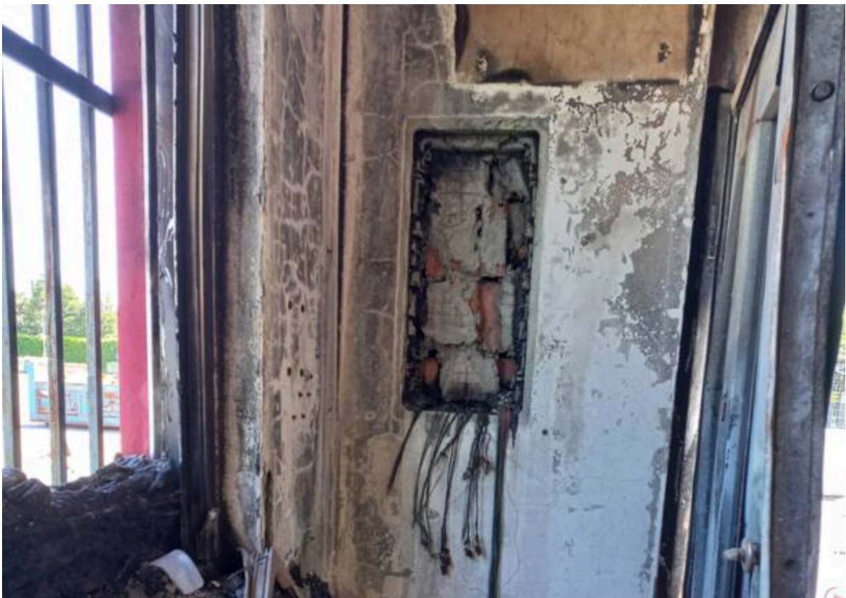
La piattaforma ecologica di via Bergamina dopo l'incendio
